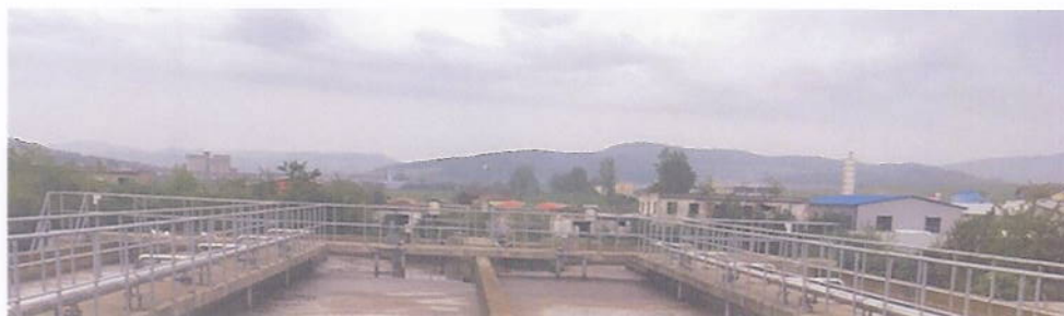
Figura 17 Compania de Apă Someș SA – stația de epurare Zalău
